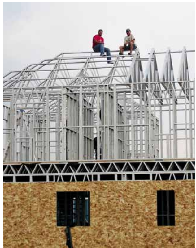
Casa modelo para um empreendimento residencial com 50 unidades em Lubumbashi, República Democrática do Congo, construído pela Moya Homes nos finais do ano de 2008.
